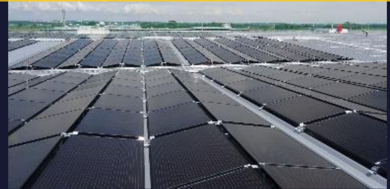
Flughafen München 1,13MWp
